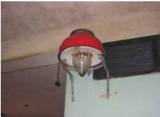
Installierte Frankfurter Gaslampe in der Küche des Hotels Las Tecas
